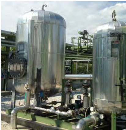
Serbatoi acqua potabile e acqua di raffreddamento
