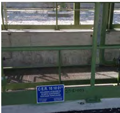
Serbatoio acqua da collettore pozzi
