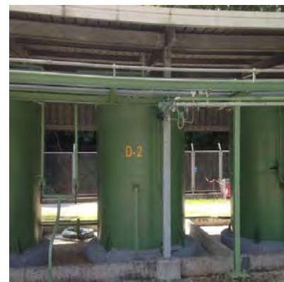
Serbatoi acqua di strato CN4 e glicole
