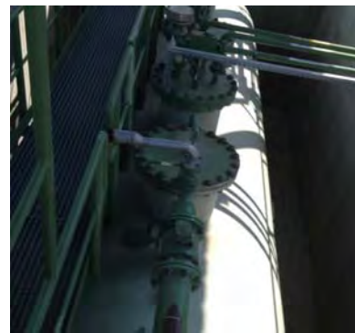
Serbatoio drenaggi glicole
