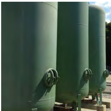
Serbatoi accumulo aria compressa
