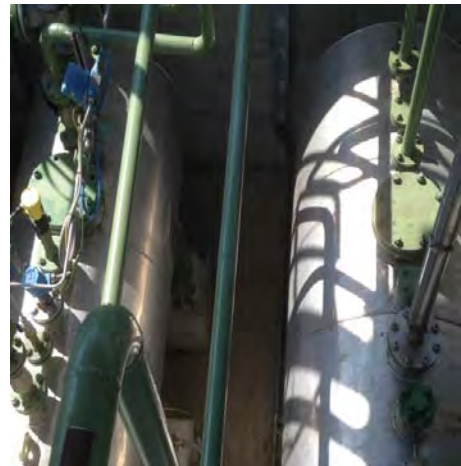
Serbatoio scarichi compressori e separatori
