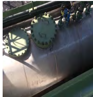
Serbatoio acqua da collettore pozzi
