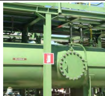
Serbatoio glicole pulito
