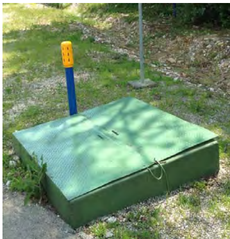
Serbatoio separatori cluster
