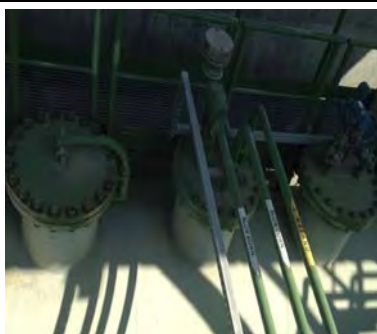
Serbatoio drenaggi glicole
