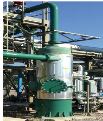
Guardia idraulica termodistruttore
