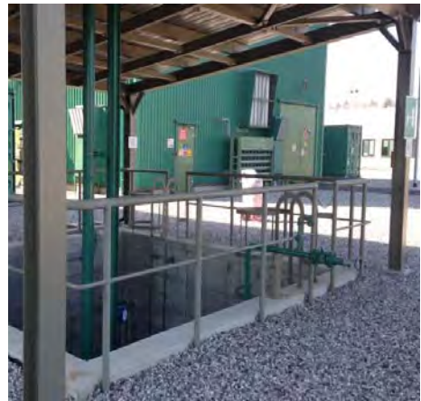
Drenaggi compressori gas
