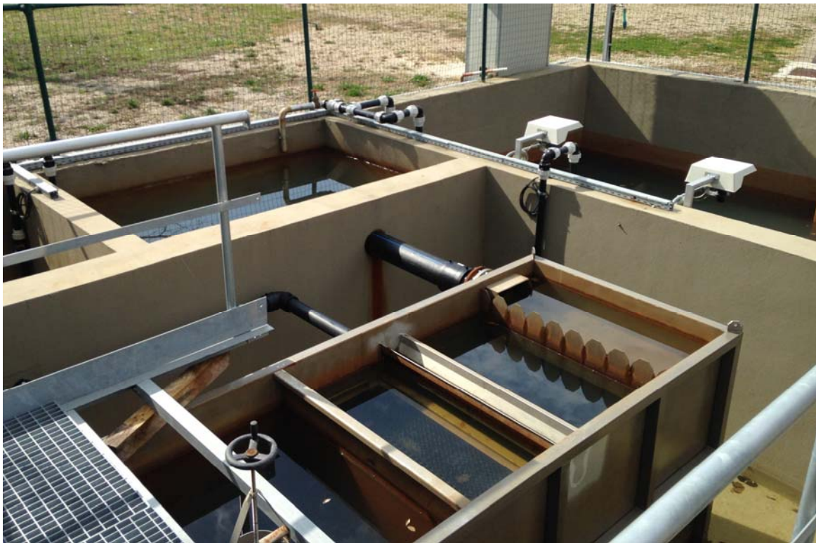
Impianto raccolta separazione e trattamento acque di prima pioggia
