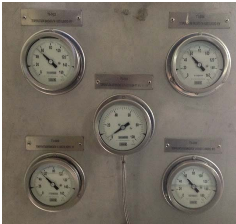
Pannello "a bordo macchina" parametri compressore
