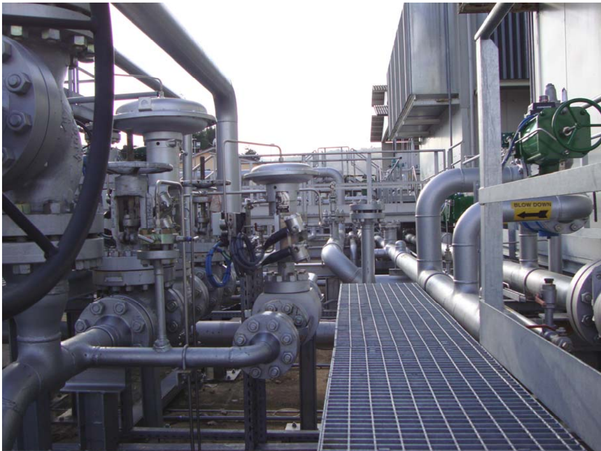
Vista degli impianti
