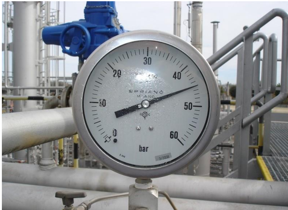
Misuratore di pressione uscita centrale
