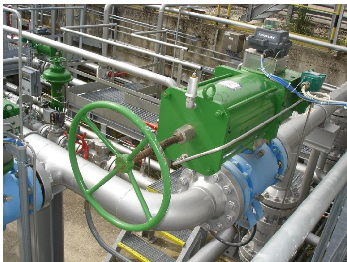
SDV (shut down valve) valvola automatica sezionamento impianto
