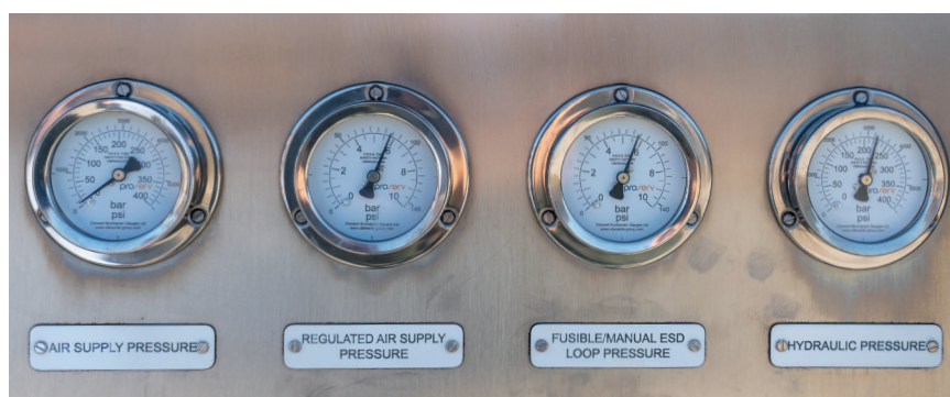
Strumentazione per il controllo e misurazione della pressione
