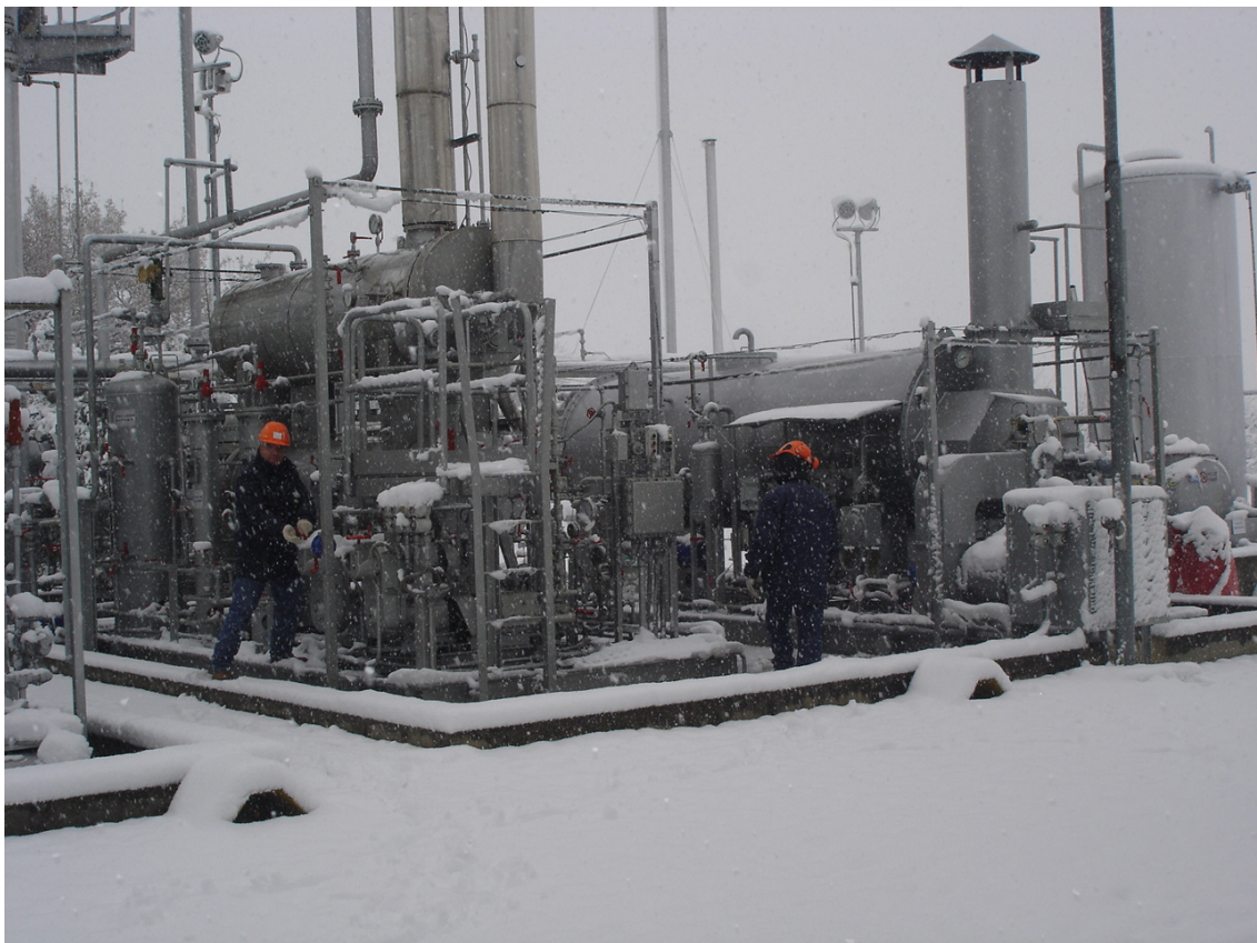
Alcuni operatori della Centrale di Cellino a lavoro sugli impianti sotto le abbondanti nevicate del febbraio 2012
