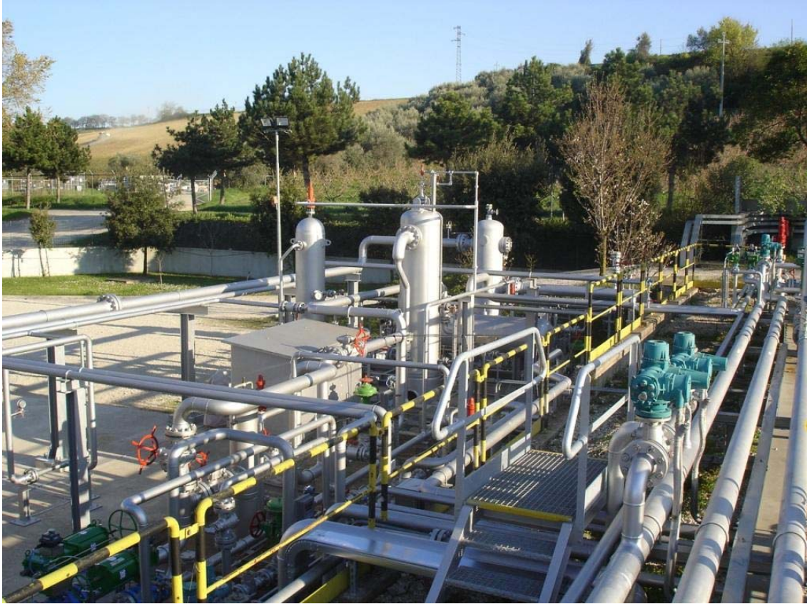
Impianti della Centrale di Cellino Attanasio (TE)
