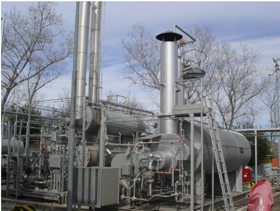
disidratazione e termocombustore
