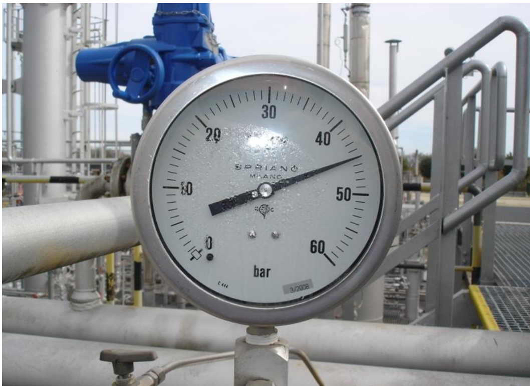
Misuratore di pressione uscita centrale
