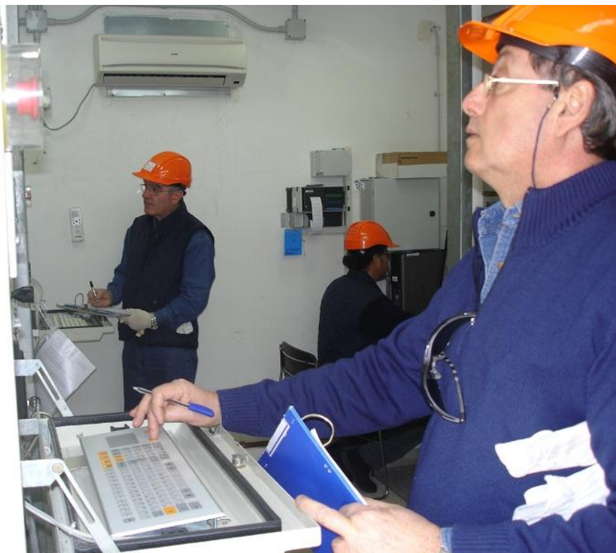
Personale dell'impianto in operazione sui sistemi di controllo (PLC compressori e DCS)
